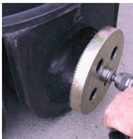
Vrtanje vstopne izvrtine z ustreznim kronskim svrdrom, adapterjem in ročnim vrtalnim strojem
